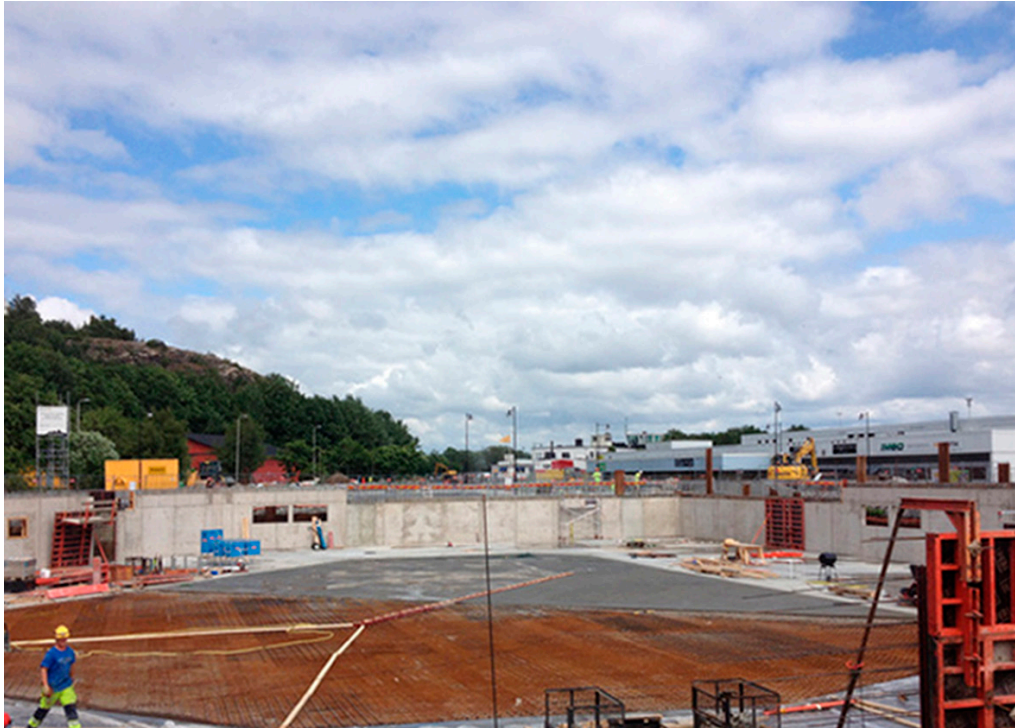
I juni månad var bottenplattan gjuten och väggarna tillgaraget under huset resta.
