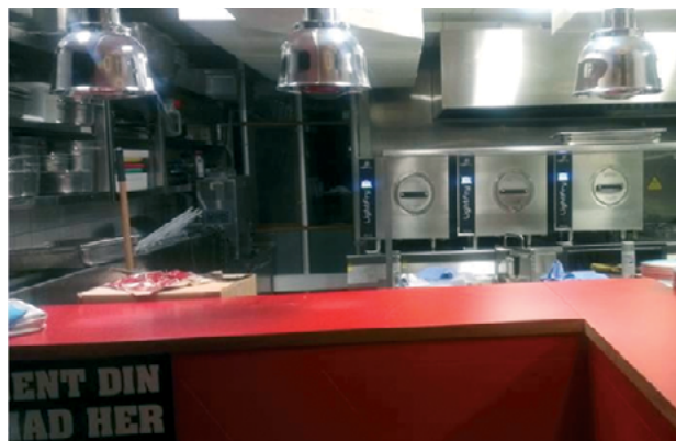
Installation av Lightfry-ugnar på nöjespark i Danmark.
